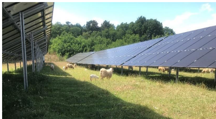
Abbildung 6: Extensive Schafbeweidung im Solarpark
